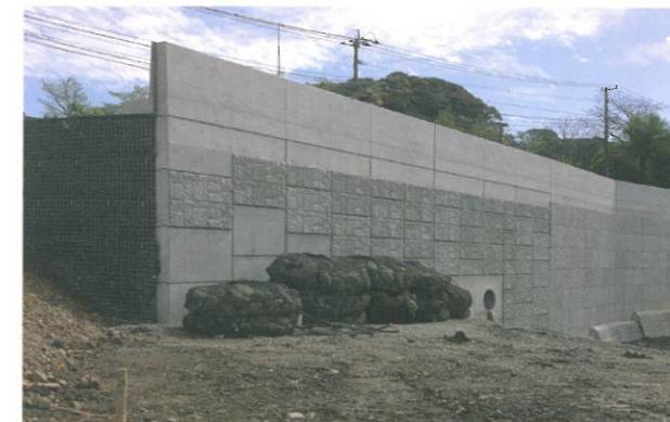
地区名/宮崎県（日向土木事務所河川砂防課） 工事名/耳川鶴野内地区道路兼用護岸工事 施工時期/2015.01
