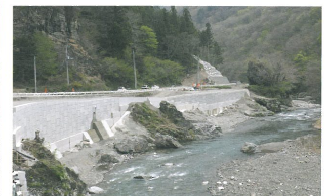
地区名/群馬県（藤岡土木事務所） 工事名/国道462号魚尾拡幅工事 施工時期/2015.06
