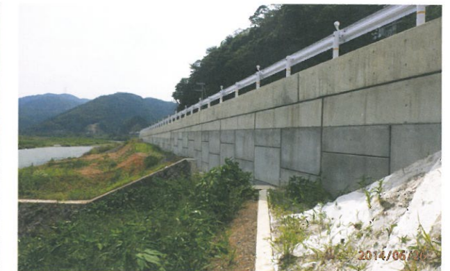
地区名/京都府（国交省近畿地整福知山河川国道事務所） 工事名/国道175号公庄地区 施工時期/2014.01
